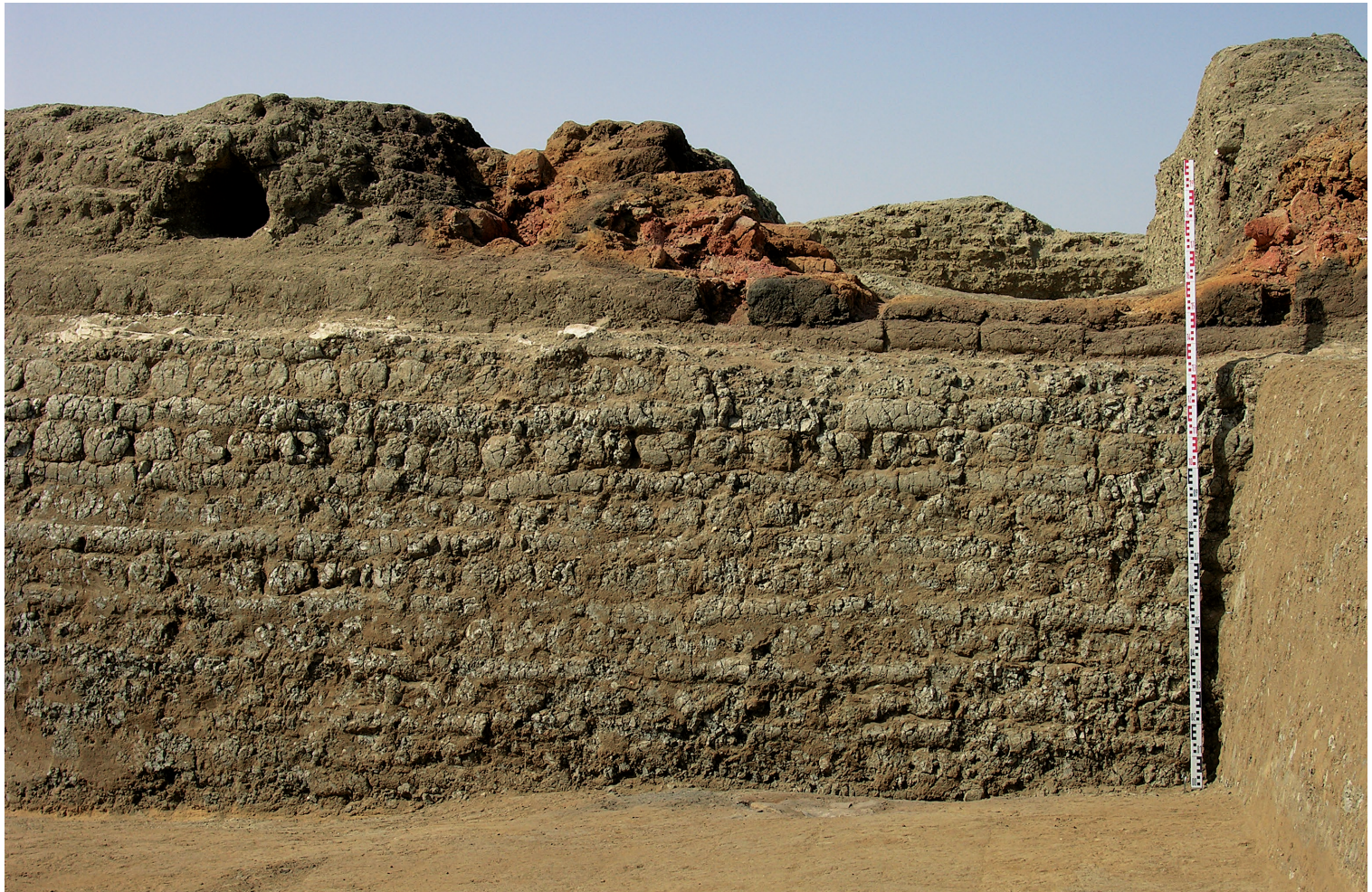
Fig. 29. Briques cylindriques argileuses et assez grossières, employées dans les fondations des murs (ici celles du mur sud de la salle principale 100C)
