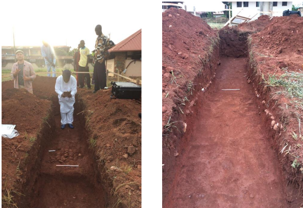
Figure 93 : Vue des tranchées de fondation le 7 juin 2017, lorsque notre équipe intervint pour arrêter la construction. À gauche, Adisa Ogunfolakan photographie le pavement en tessons de poterie mis à jour par les ouvriers (tranchée reprise en 2022 sous l'appellation USG2-1). À droite, notez les alignements de pierres dans les profils de la tranchée, qui signalent le fait que les ouvriers ont percé le pavement de pierre sur presque toute la longueur de la tranchée (tranchée reprise en 2022 sous l'appellation USG1-1) (Clichés : Mission archéologique d'Ife Sungbo, 2017).
