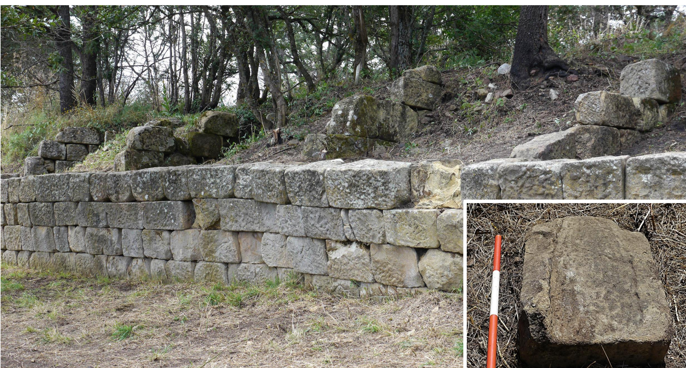
Fig. 3. Muro dell'Acropoli: dettaglio dell'alzata e delle catene murarie retrostanti; (in basso a destra) particolare di un blocco lavorato a mo' di doccione.
