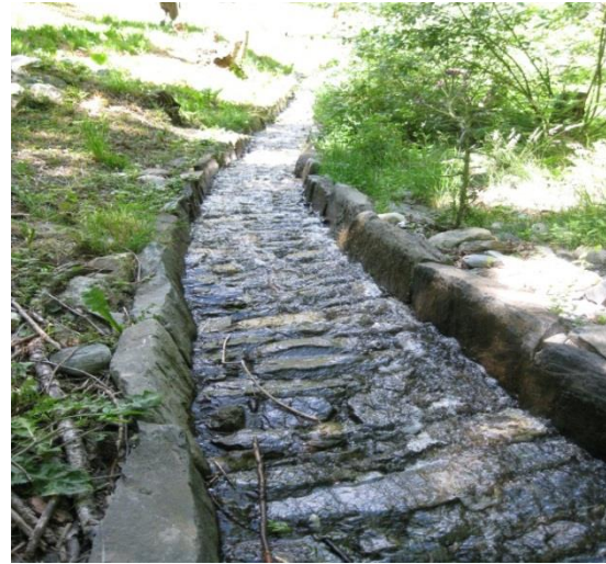
Figure 24 : Canal de l’Arc à Montrigon, section nouvellement empierrée, Bourg-Saint-Maurice, 27/6/12 (cliché B. Meilleur)
