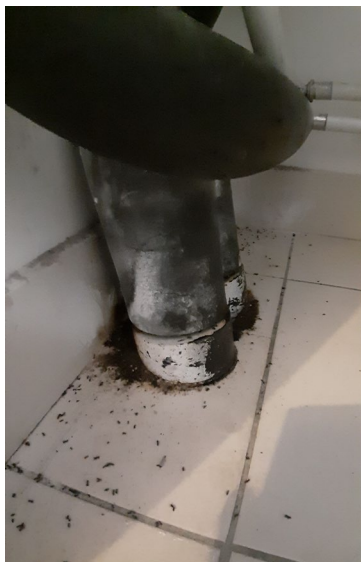
Figure 4. Dégâts provoqués par les Tapinoma le long des tuyaux d'évacuation des eaux usées dans une maison en Aquitaine. Cliché A. LENOIR.
