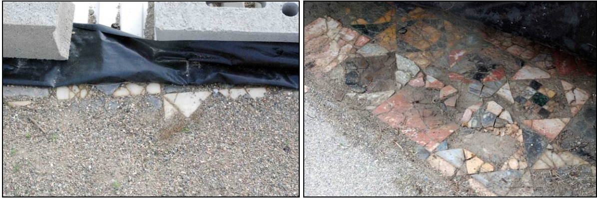
Sol en marbre protégé par du sable, une bâche et une tôle retenues par des parpaings (maison III, pièce F). Après enlèvement des protections, la présence d'humidité est visible à l'œil nu (clichés : J.-F. Modat).
