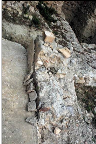
Exemple d'un enduit mural en état de dégradation avancé (cliché : J.-F. MODAT).
