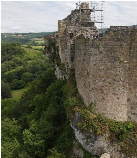
Fig. Caractère surplombant de la falaise au nord du sommet entre le châtelet et la retaille (33). Crédit F. Guillot
