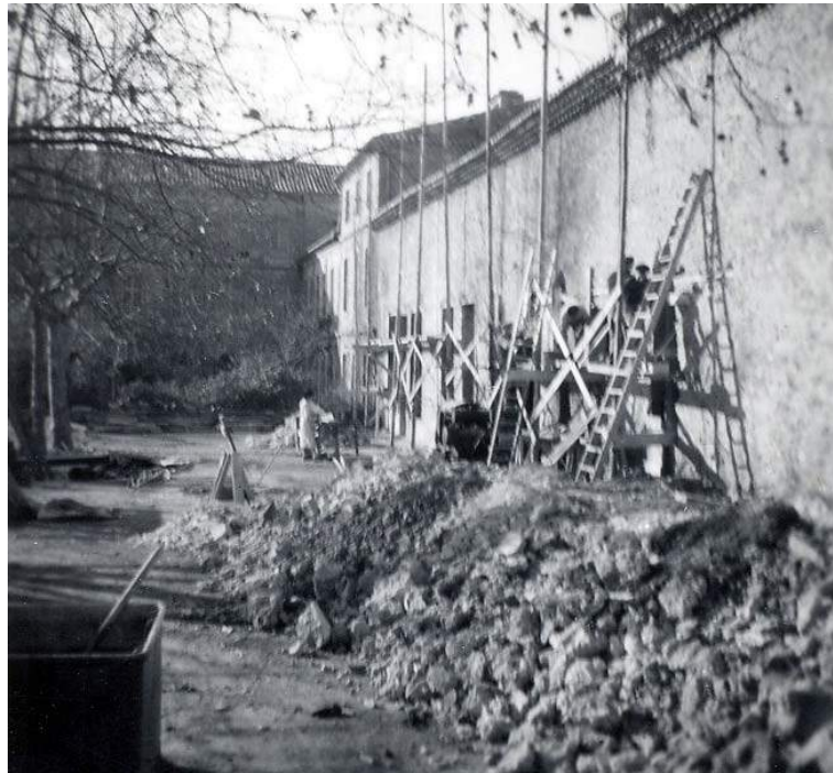
Fig. 39 - Travaux sur le bâtiment agricole Nord-Est lors de l'aménagement du C.E.T. des Arts Ménagers de Cassan (1946). © S. SOTOS
