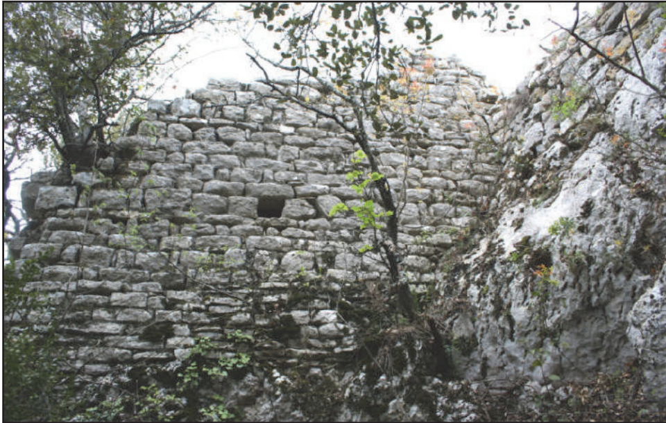
Fig. 105 : Le mur MR 5a vu du nord, composé de moellons calcaires équarris et présence d'un trou de boulin (photo : F. Loppe, 2012).
