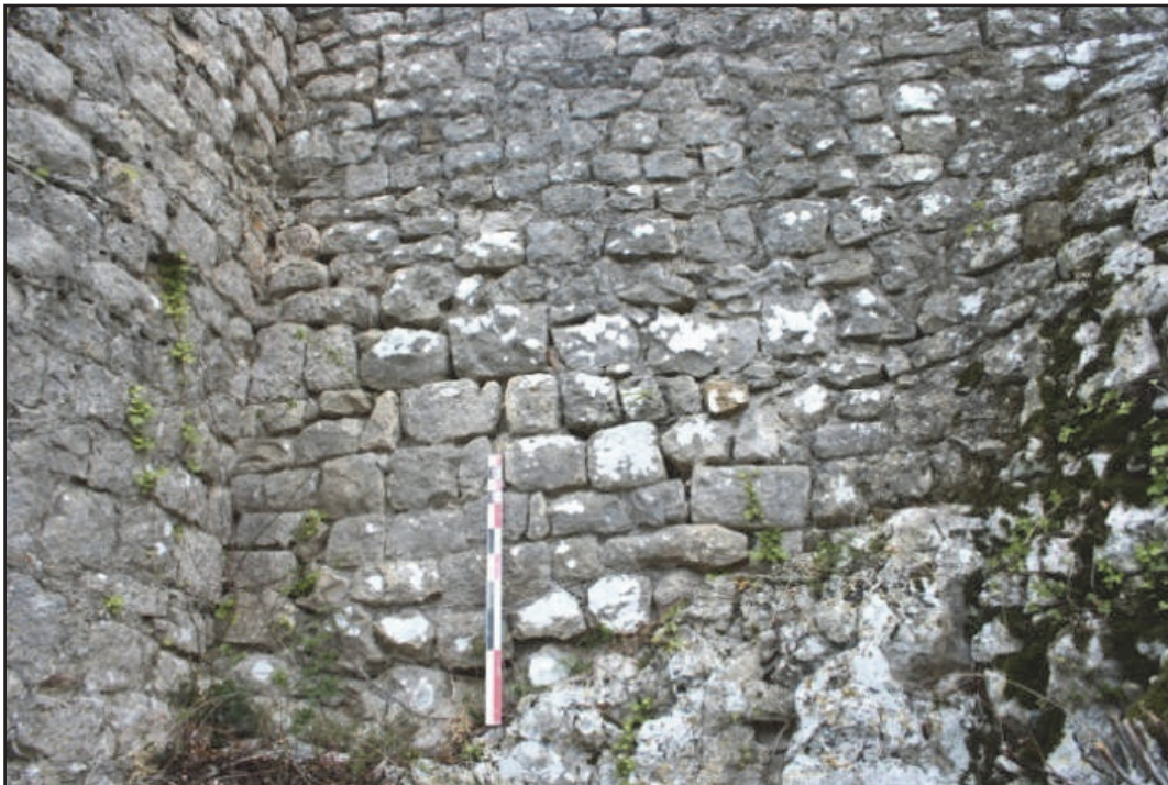
Fig. 97 : Vestige du mur MR 6f au sud de la tour TO 1 (photo : F. Loppe, 2012).
