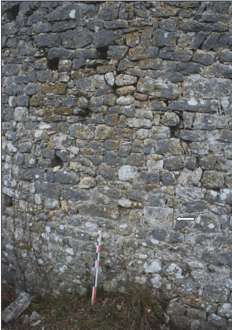
Fig. 92 : MR 6d, reparablement situé au nord du mur MR 6a. On notera la présence d'une pierre de taille de calcaire blanc (flèche) dont le gabarit rappelle celui des moellons du donjon arasé (photo : F. Loppe, 2012).
