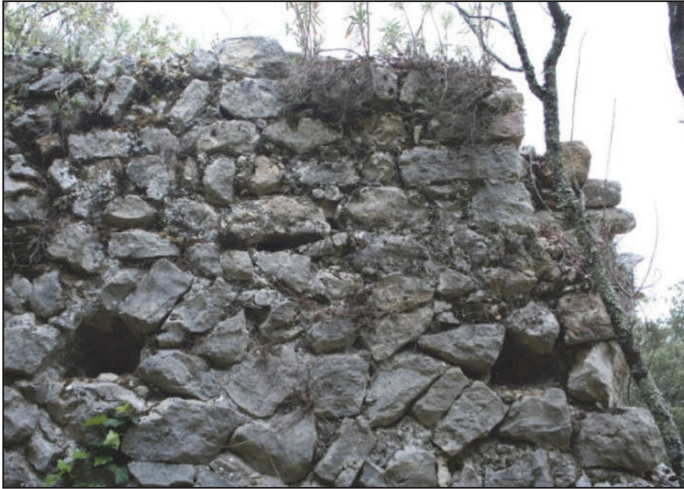
Fig. 116 : Assises horizontales des parements de la maçonnerie MR 10b (photo : F. Loppe, 2012).
