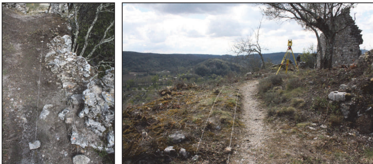
Fig. 6 : Matérialisation des tranchées du garde-corps. À gauche la TR 1, à droite les TR 2 et 3.
