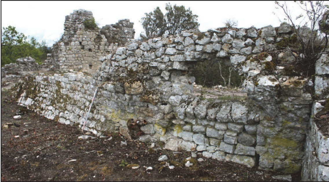
Fig. 80 : Le mur MR 4 vu du sud-ouest, appuyé à droite contre le donjon arasé (photo : F. Loppe, 2012).
