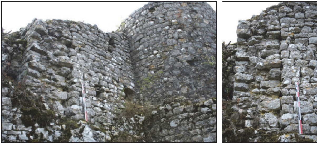
Fig. 75 : Arrachement du mur MR 1 à l'ouest (photos : F. Loppe, 2012).
