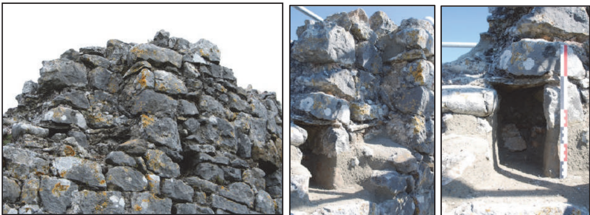
Fig. 87 : MR 6a, vestiges d'un chemin de ronde présentant un système de circulation charpenté en bascule (photos : F. Loppe et J.-F. Modat, 2012).
