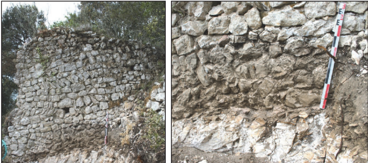
Fig. 112 : Parement est du mur MR 10 dont les assises reposant sur le substrat rocheux suivent la pente (photos : F. Loppe, 2012).
