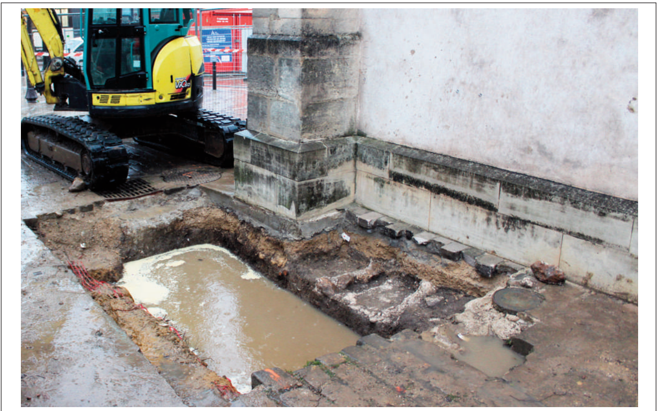
Fig. 14 : eau pluviale stagnante dans la tranchée 1.
