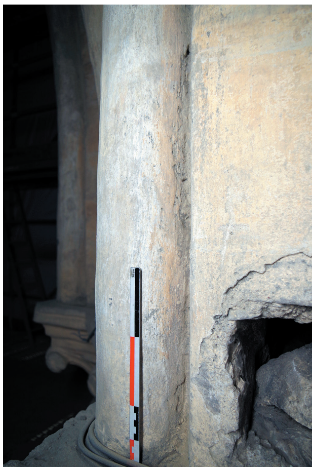
fig. 44 : Intrados de l'arcade NORD de la travée 1, retombée OUEST, le badigeon rose-orangé déborde sur le badigeon blanc du tore (UE 2).
