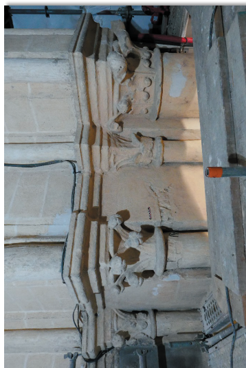
Pilier 1, face nord : derrière l'enduit, un joint épais sert à rehausser le niveau de pose des chapiteaux les plus à l'est
