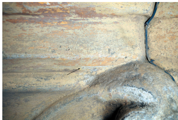
fig. 37 : Pilier 1a, face SUD-EST : détail du faux-joint blanc sous l'abaque.
