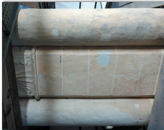
Pilier 1a, face sud-ouest : césure verticale dans l'enduit
