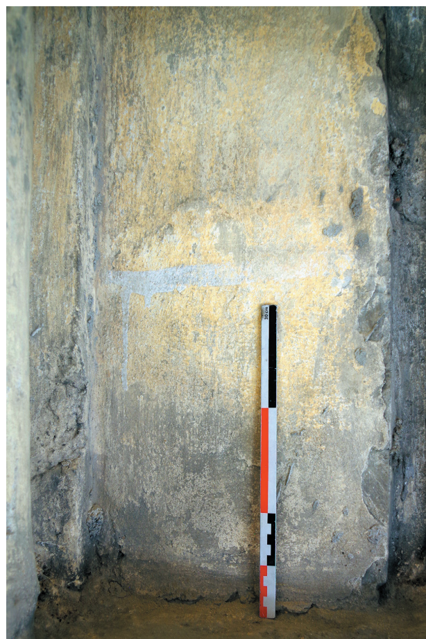
fig. 45 : Retombée SUD-EST de la voûte, front de l'arcade ouvrant sur le chœur, traces de coulures du badigeon blanc des faux-joints (UE 2).
