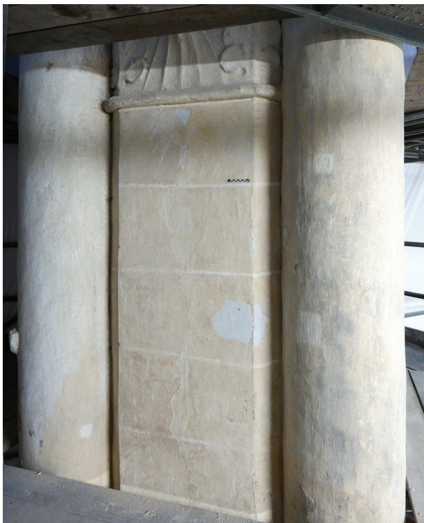
fig. 32 : Pilier P 1a, face SUD-OUEST, couture verticale entre l'UE 22 (à gauche) et l'UE 1 (à droite).
