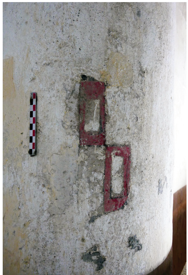
fig. 83 : Élévation OUEST du pilier P 1a, écu peint (UE 18).
