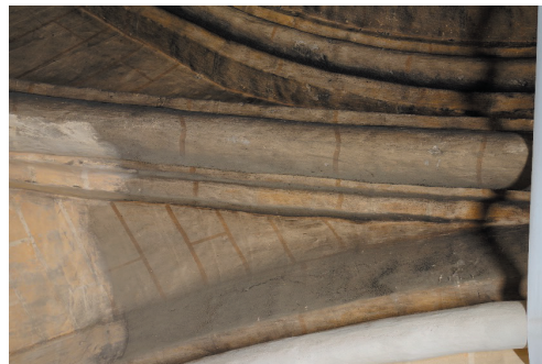
Retombées sud-est de la voûte en cours de dépeussinage - décor à faux-joints rouges du XIX e siècle (UE 3)
