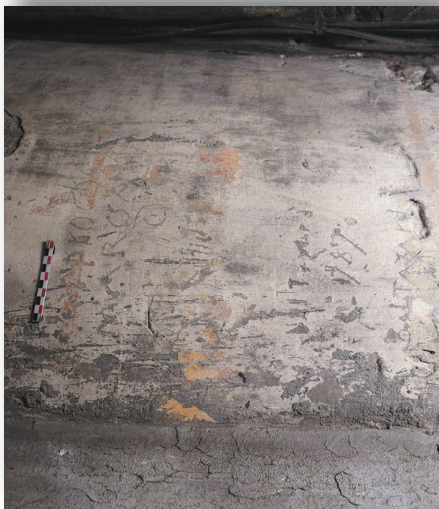
Pile 3, face nord-est du fût, vue d'ensemble des graffiti
