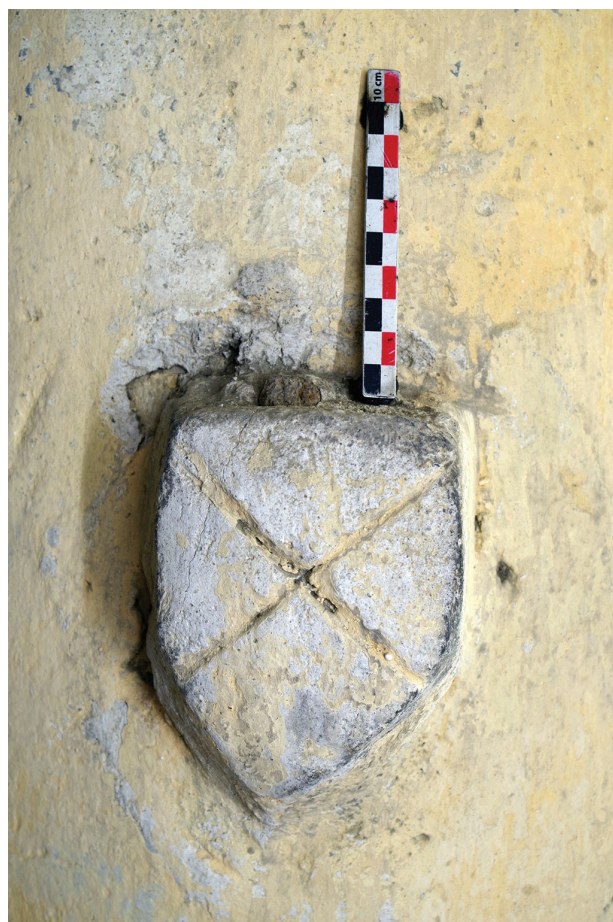
fig. 87 : Élévation OUEST du pilier P 1a, colonne engagée, écu fiché dans la colonne.
