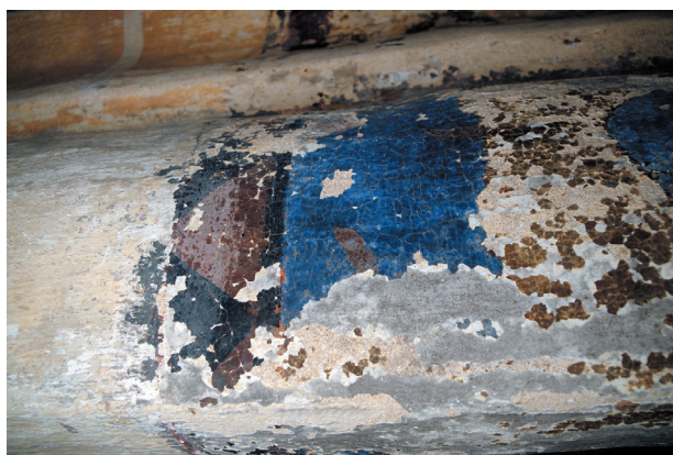
fig. 61 : Torse de l'ogive NORD-OUEST, face SUD, détail de la frise de chevrons noirs et rouge ; détail des griffes rouge des pattes du lion.
