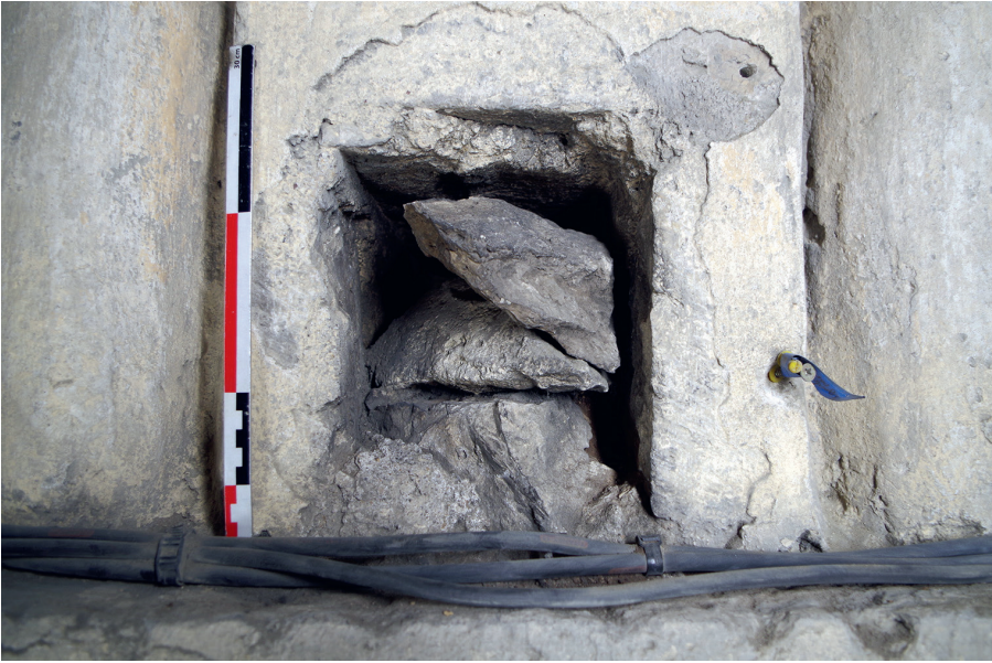
fig. 22 : Trou d'ancrage dans la face EST du pilier P 1a ; les deux pierres sur la moitié supérieure correspondent à un bouchage en surface de l'ouverture.
