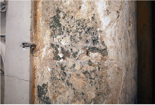
fig. 81 : Pilier de la croisée du transept P 1, colonne engagée NORD, les couches picturales du décor UE 21 sont appliquées dans les lacunes de UE 1.
