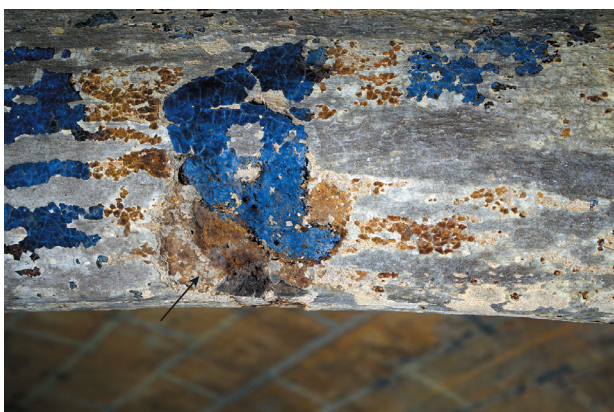
fig. 57 : Torse de l'ogive SUD-OUEST, face EST : la polychromie recouvre une lacune de l'enduit UE 1.
