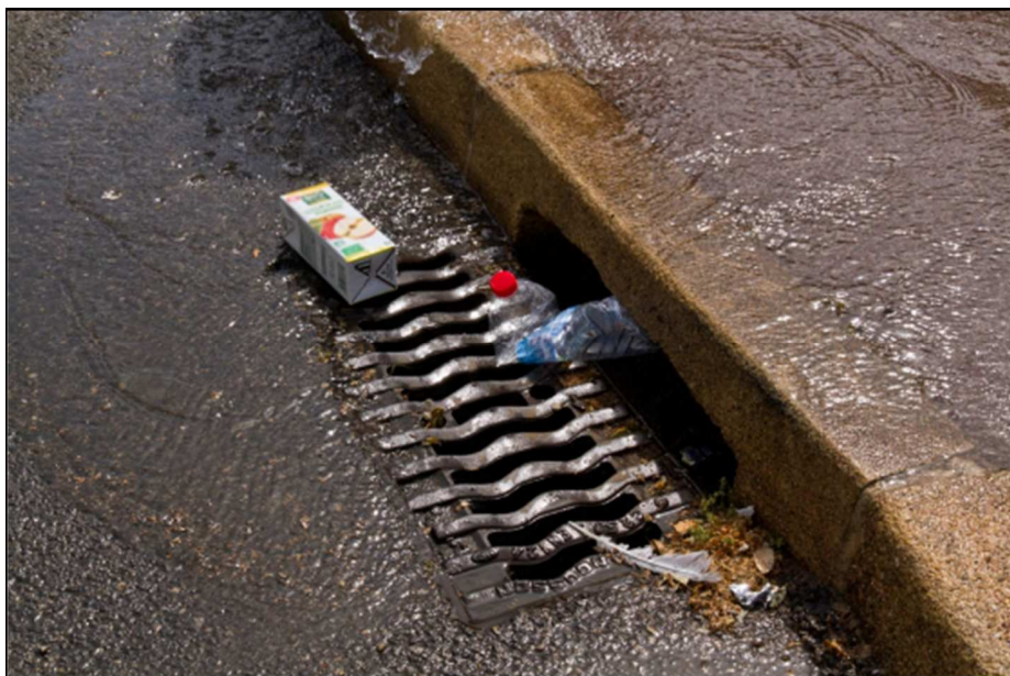
Figure 19 : Photo d'un avaloir obstrué dans la métropole de Toulon ( https://metropolepm.fr ).
