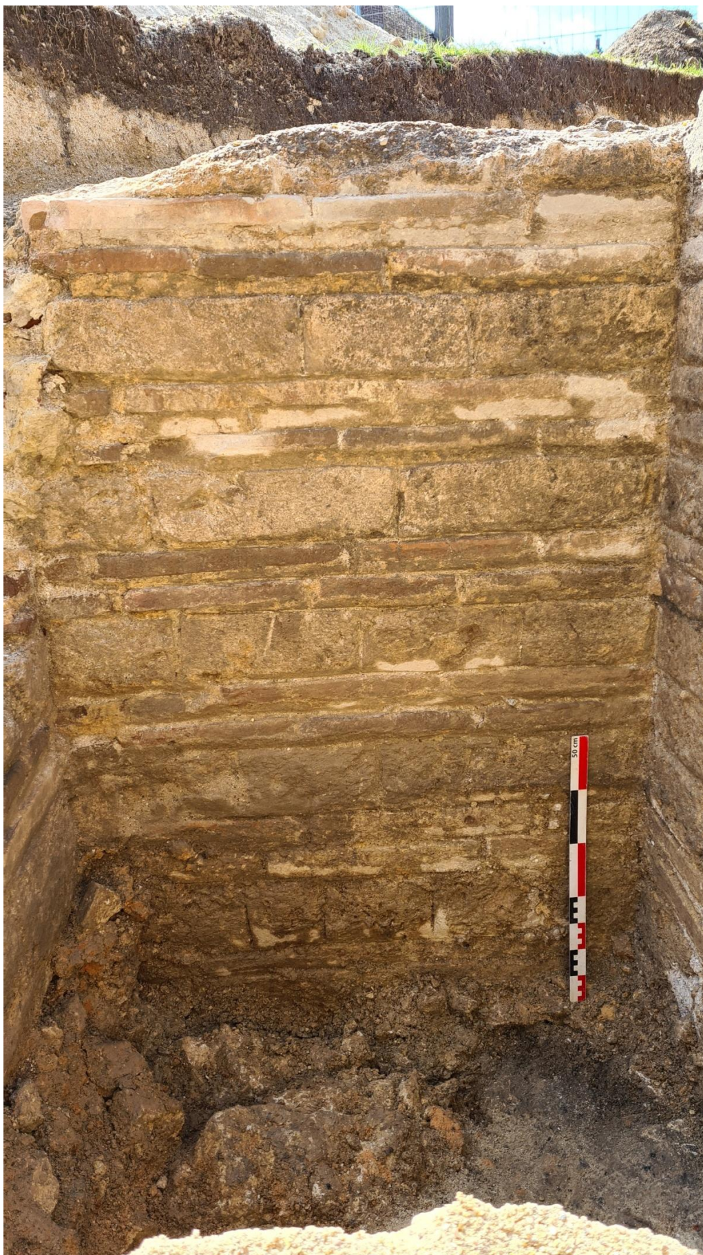
Élévation du parement externe du mur 1 conservé sur au moins 1,6 mètre de haut © Spiesser - Caux Seine Agglo
