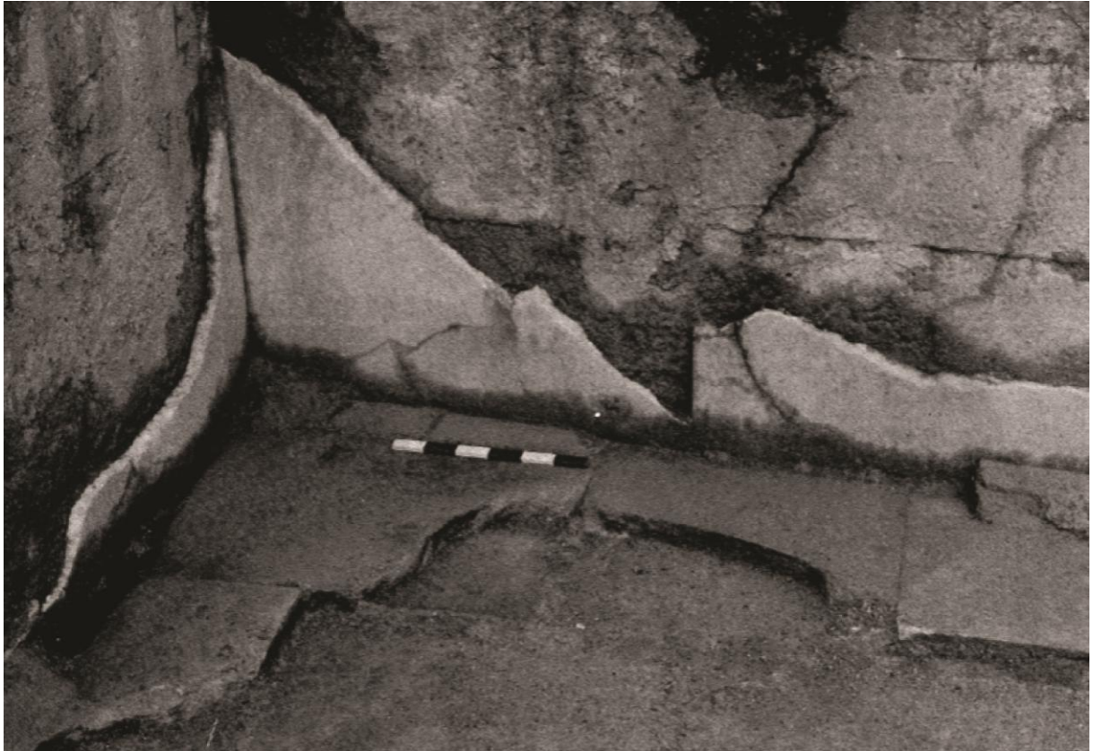
Photographie du dallage et des éléments de placage en place dans la piscine © Pitte 1985
