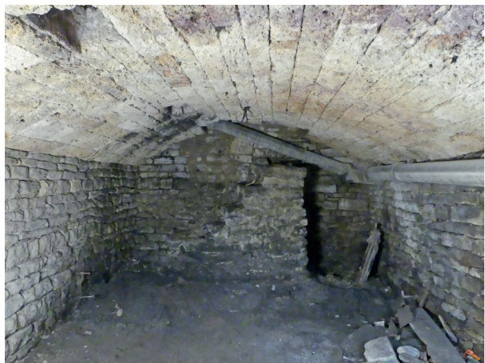
fig. 9 La cave C2 vue du nord, avec sa voûte VT1022 et au fond son escalier d'accès.
