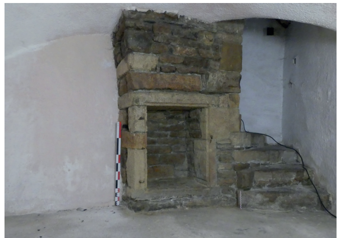
fig. 31 Partie occidentale de la cave C3, vue de l'est, avec l'escalier ES1017 d'accès et la niche 1027.
