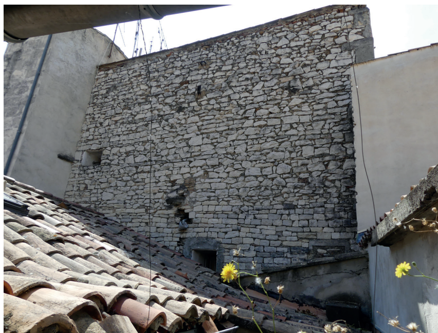
Fig. 53 Le troisième étage du corps méridional, dominant les toitures du reste de l'immeuble, vu du nord. On remarque en particulier la reprise du mur MR1012 qui, au niveau du deuxième étage présente son appareil régulier de l'état 2 et au-dessus deux reprises. La première est de l'état 5. La seconde est ponctuelle.
