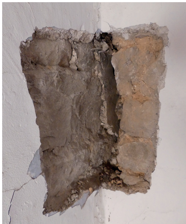
Détail de l'appui du mur MR1005 (à droite) sur le mur de refend d'îlot MR1002 (à gauche). On note l'enduit du mur MR1002 préexistant à l'appui et le décollement assez prononcé du mur MR1005 (décollement qui se développe sur toute la largeur du mur, donc traversant). (L. Wozny).
