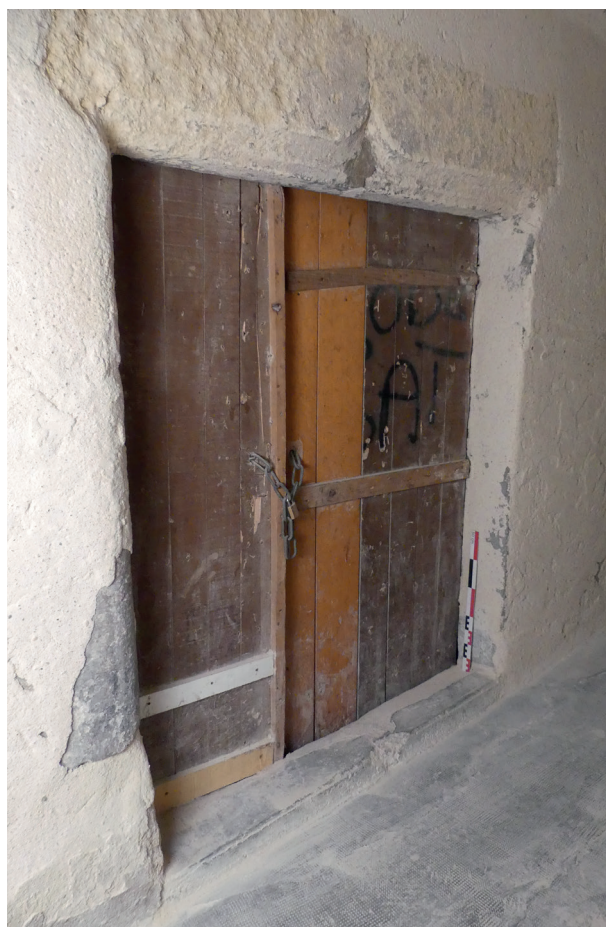
Fig. 9 La porte d'entrée 1013 de l'aile occidentale de la maison (état 2). Vue de l'extérieur, du sud-est. Cl. O. Maufra/Inrap.
