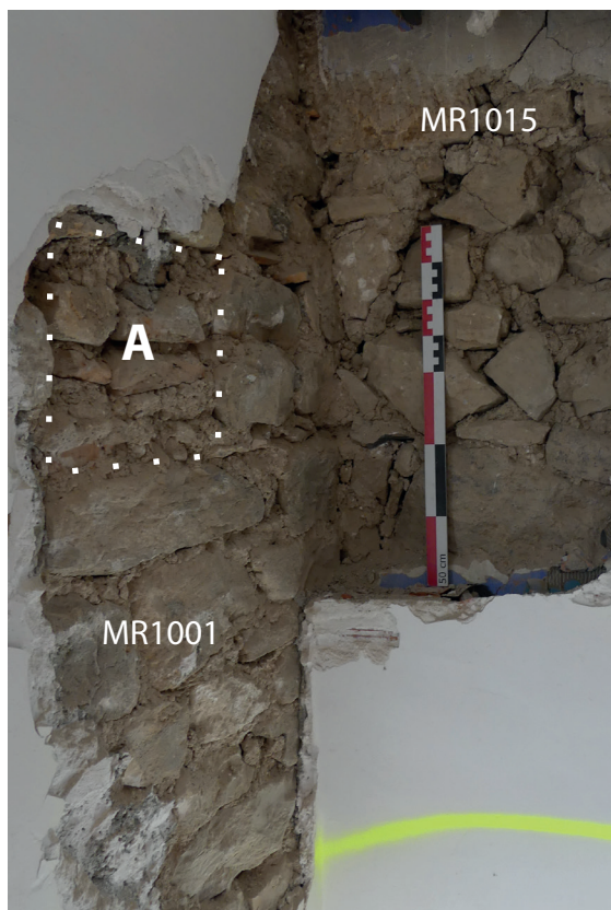
Fig. 52 L'angle sud-ouest de la pièce 216 (corps méridional, deuxième étage) à l'emplacement des reprises. À gauche la façade MR1001 avec sa maçonnerie d'origine à la base (état 2), l'emplacement d'une panne de la première toiture (A) et au-dessus la reprise de l'état 5. À droite, la reprise d'exhaussement du mur MR1015 (état 5) adossée contre la partie ancienne du mur MR1001 et (hors champ) chaînée à la reprise de la façade. Cl. O. Maufra/Inrap.
