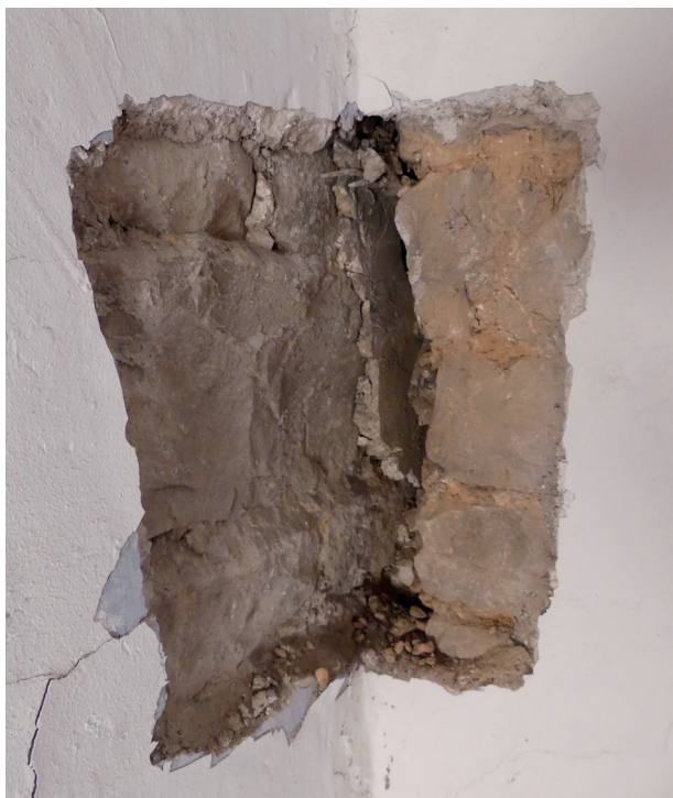
Détail de l'appui du mur MR1005 (à droite) sur le mur de refend d'îlot MR1002 (à gauche). On note l'enduit du mur MR1002 préexistant à l'appui et le décollement assez prononcé du mur MR1005 (décollement qui se développe sur toute la largeur du mur, donc traversant). (L. Wozny).
