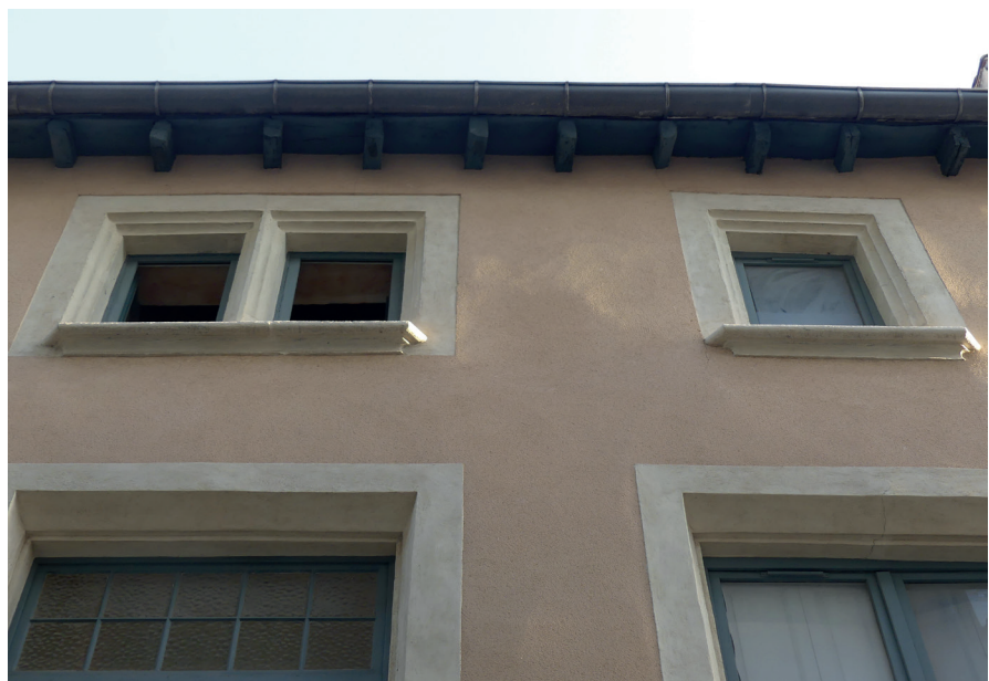
Fig. 25 Les fenêtres 1127 et 1128 au deuxième et dernier étage, mur de façade sur rue MR1001, état 4. Cl. O. Maufra/Inrap.
