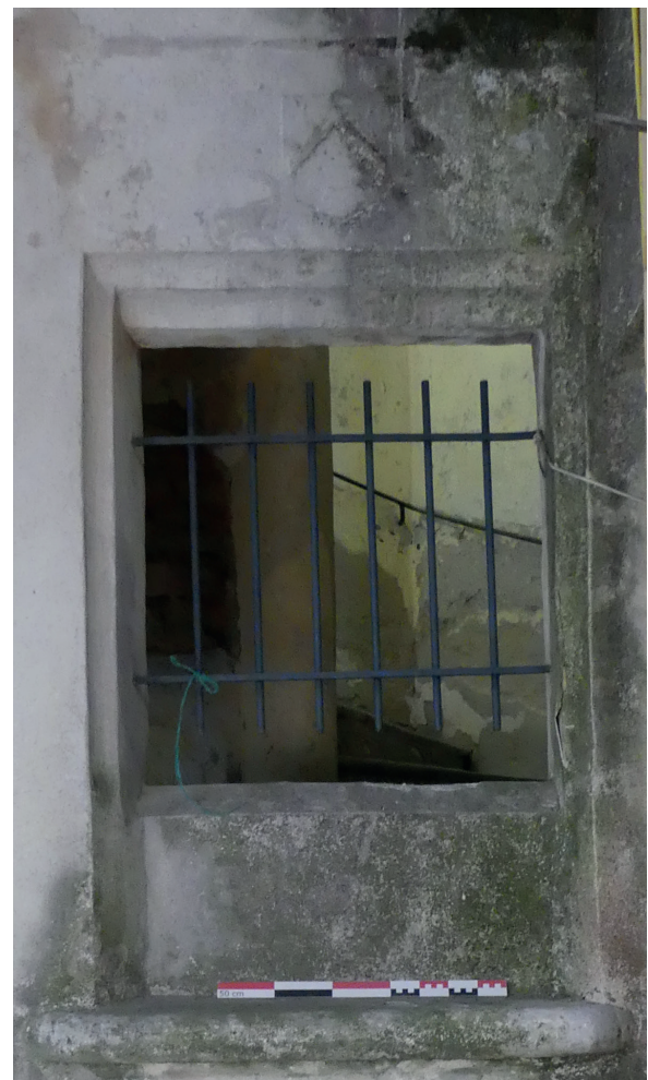
Fig. 30 La fenêtre 1029, éclairant la première révolution de l'escalier ES1026 depuis la cour. Cl. O. Maufra/Inrap.
