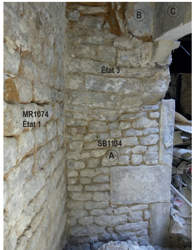
Fig. 38 Le pilier occidental SB1134 vu du sud. À gauche le mur MR1074 de séparation de la parcelle voisine. Au centre, la face méridionale du pilier avec la maçonnerie de son deuxième état en haut et la consolidation en sous-œuvre ( A ). En haut à droite, l'extrémité de l'arc 1133 ( B ) qui a été remplacé tardivement et l'arc formeret ( C ) de la voûte porteuse de l'escalier ES1075 de l'état 4
