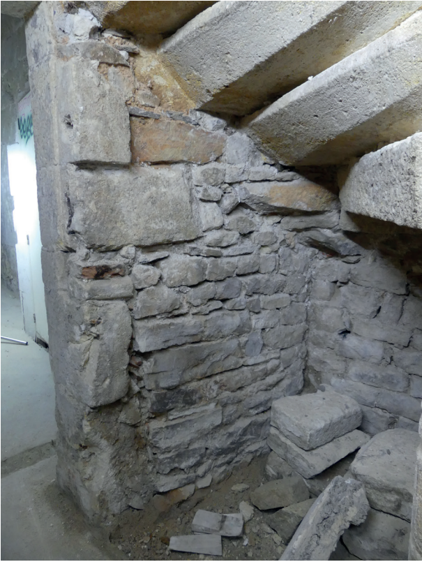
Fig.15 Détail de l'appui du mur MR1042 (à gauche, avec sa porte 1104) contre le mur MR1073 (à droite, sous la première révolution de l'escalier ES1103). Les deux murs ferment la cage d'escalier respectivement à l'ouest et au nord (photographie prise du sud-est). On note que l'angle a été repris en hauteur, sous des marches qui ont été changées
