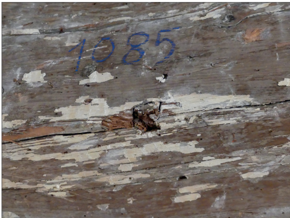
1085 - Plafond PL1083 au deuxième étage (pièce 212) : détail de la poutre 1085 et de sa cheville de ligature
