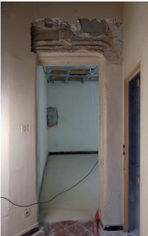
Fig.46 La porte 1060, entre les ailes du nord (pièce 13, au premier plan) et de l'est (pièce 18, au fond) au premier étage de la maison méridionale. Vue de l'ouest
