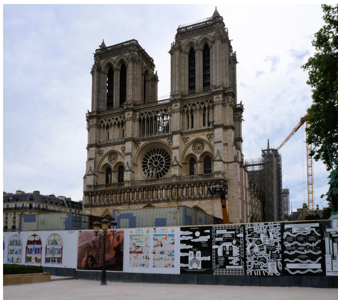
Fig. 2 – L'exposition en plein air sur le chantier de sécurisation et de consolidation de la cathédrale. © Julien Bastoen, Juin 2022.
