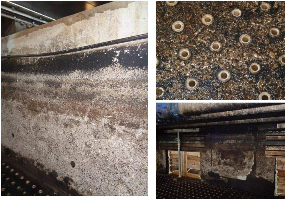
FIGURE 1. Photographies de la partie supérieure d'un bassin de traitement biologique aéré – à gauche la paroi du bassin, en haut à droite, le plancher du bassin et en bas à droite la paroi avec la sortie du bassin.
