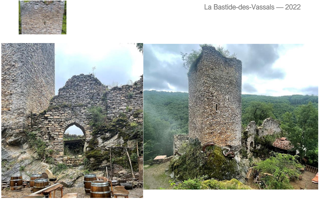
Fig. Entrée ouest du château de la Roque et tour maîtresse. Crédit F. Guillot
