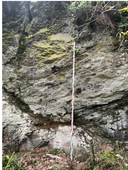
Fig. Falaise retaillée sous le château au sud-sud-est (sous le M8), secteur des aménagements sous le château « terrasse inférieure). Crédit Florence Guillot.
