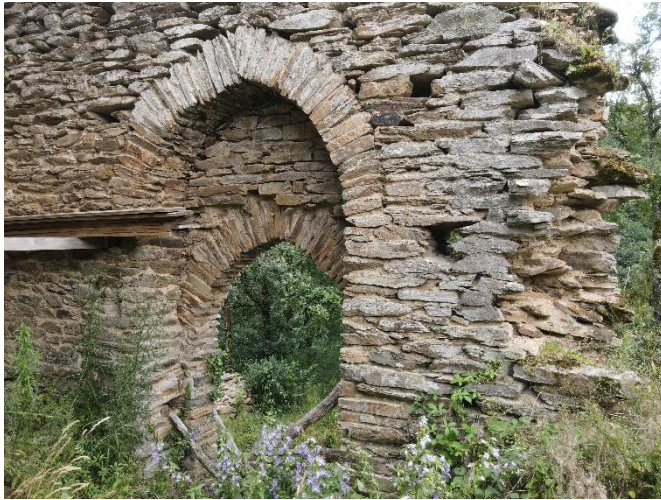
Fig. P2 interne (M7) ; la poutrelle ronde en bas à gauche du piédroit est insérée dans le trou de barre de la porte. Crédit Florence Guillot.
