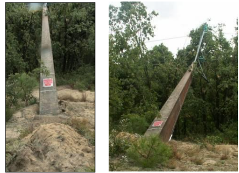
Figure 11 : Chute d'un pylône 63 kV dans les Landes pour problème de fondation lors de la tempête RENATE en 2006
