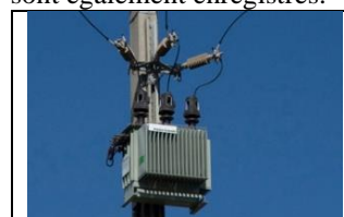
Fig 37 : Transformateur HTA/BT haut de poteau en zone rurale
