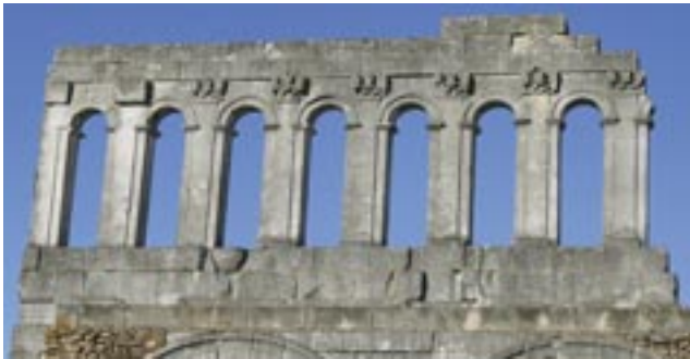
Fig. 4 Porte d'Arroux. Vue du revers de la façade au niveau de la galerie supérieure : les blocs de chapiteaux sont bruts ou seulement épannelés (cliché V. Barrière).
