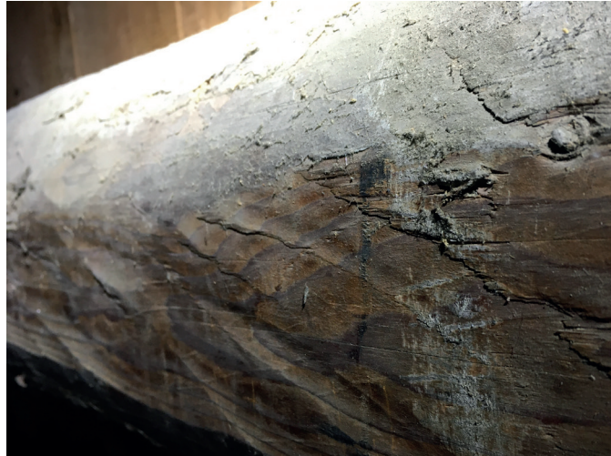
Fig 86 : Traces d'équarrissage à la hache sur l'entrait de la ferme 1. Cliché : Equipe de fouille.
