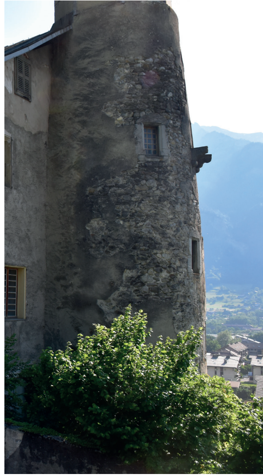
Fig 11 : Vestiges d'une structure en encorbellement sur la tour sud. Cliché : Equipe de fouille.
