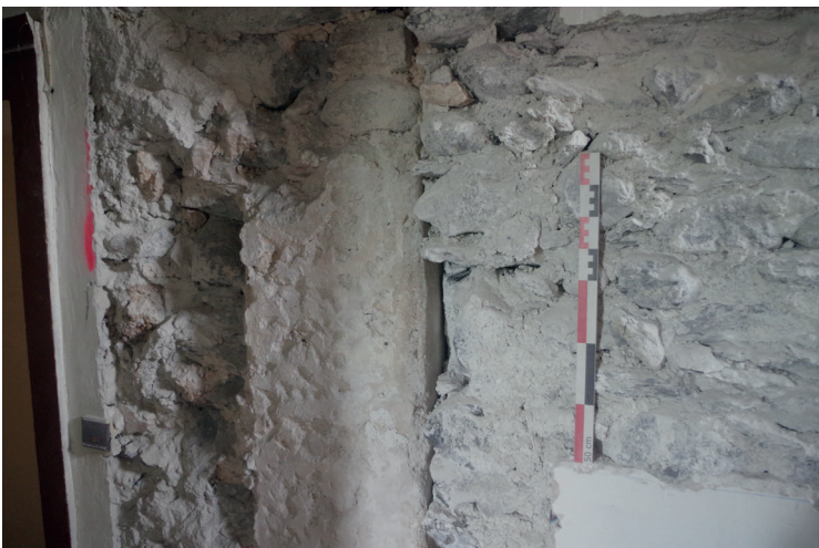
Fig 70 : Vestiges d'un enduit ancien sur le mur de refend M 1010.
