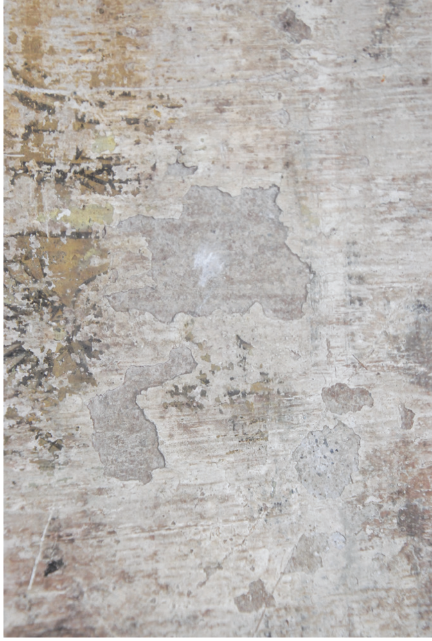
Autres pertes matérielles du chaulage, partie centrale de l'élévation est
