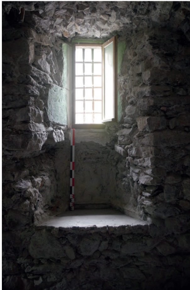
Appui détruit de la fenêtre FEN 1048.
