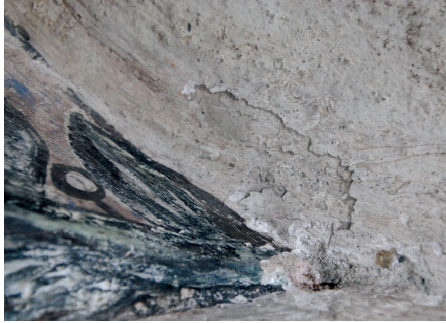
Lacune du chaulage dans le coin supérieur gauche, élévation nord
