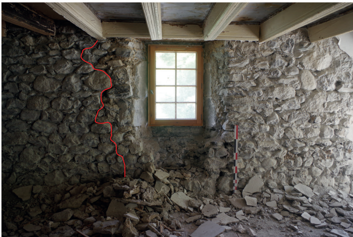
Fenêtre FEN 1090 depuis l'intérieur. Le jambage oriental est repoussé provoquant une césure dans la maçonnerie.
