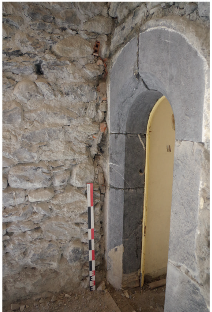
Césure verticale entre M 1001 et M 1004 au niveau de la porte POR 1066..
