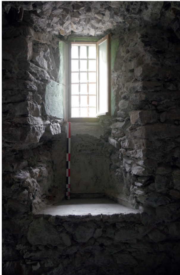
Appui détruit de la fenêtre FEN 1048.
