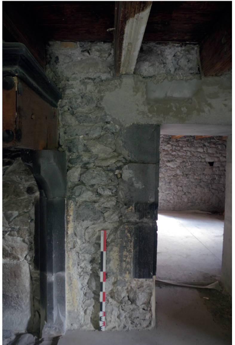
Porte POR 1042 mise en place dans un ancien placard dont il subsiste le piédroit oriental.
