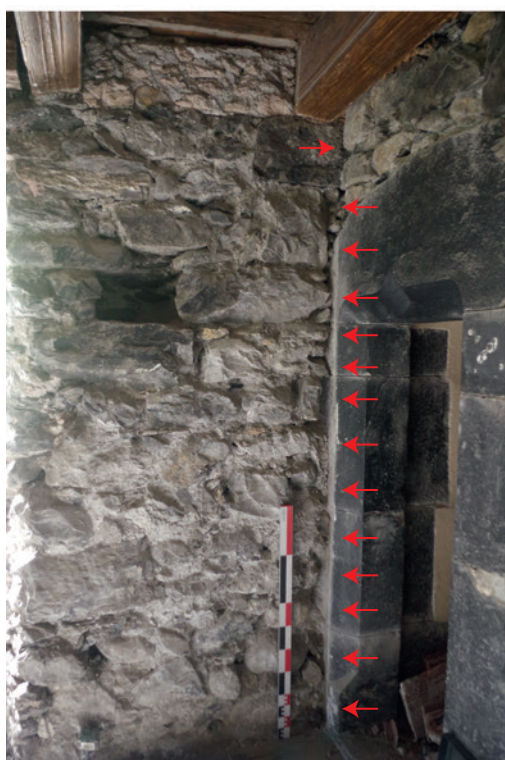
Coup de sabre dans l'angle sud-ouest.
