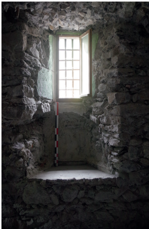
Appui détruit de la fenêtre FEN 1048.
