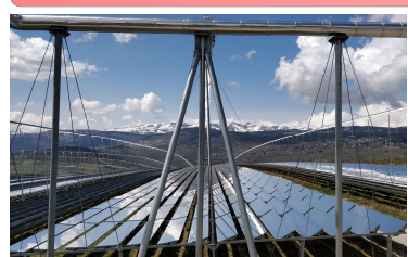
Figure 5 : Photo d'une ligne solaire eLLO
