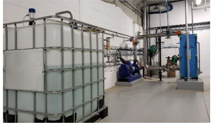
Partie souterraine : cuve d'eau, pompe et échangeur
