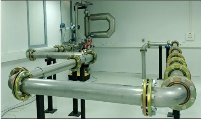
Partie principale : débitmètres de référence et tuyauterie
