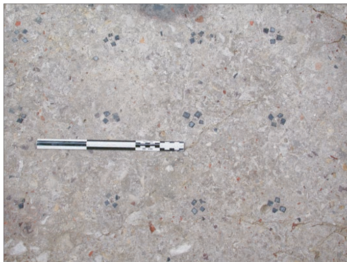
Fig. 8 – Reims, rue Eugène-Desteuque : détail des croissettes de l'opus signinum (cliché : Inrap).
