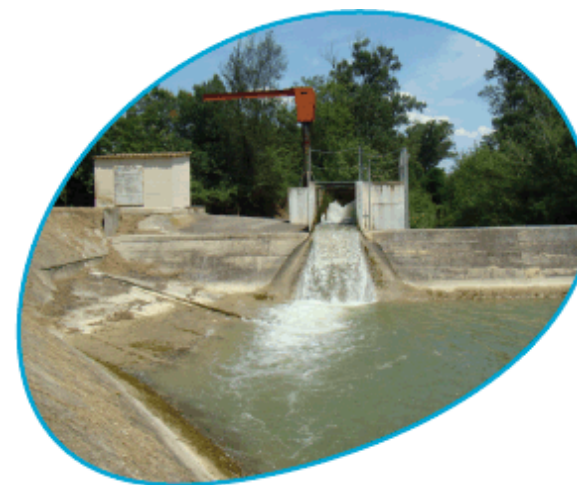
Station de pompage, Etang de l'Or
