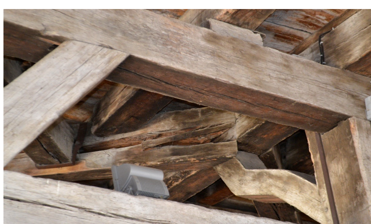
(a) Fente au niveau de l'enrayure
