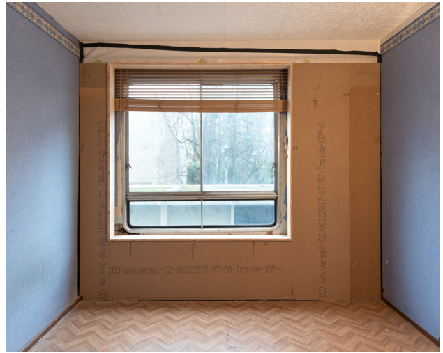
Photo de la loge après pose du prototype 2 (avant pose du Fermacell) Cl. Sabine Serrad, 25 janvier 2020
