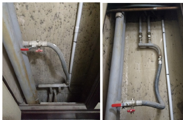
Les gaines paliers de l'immeuble Cl. TRIBU, 2019
