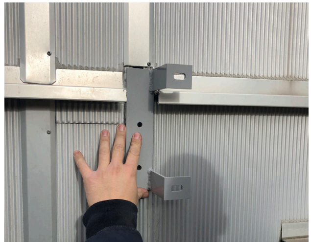
Pose des pattes de fixation dans les joints entre panneaux Mathilde Padilla, 2019
