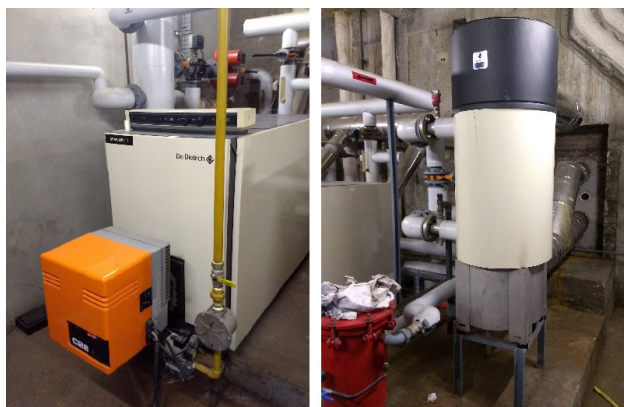
Une des chaudières et le condenseur de l'immeuble Cl. TRIBU, 2019
