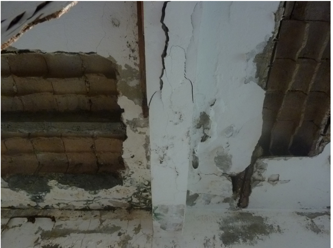
Écorché de l'enduit de protection des plafonds et des hourdis de l'école Sainte-Geneviève, vacante depuis 30 ans
