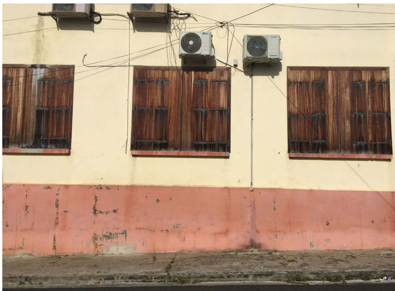
Groupe scolaire de Morne-à-l'Eau, façade sur rue des classes : les fissures montrent les emplacements de l'ossature et des différents types de maçonnerie. La construction est visible au-delà des apparences de monolithisme données par les enduits
