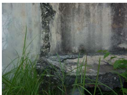
Bétons non protégés de la citerne de l'école Sainte-Geneviève
