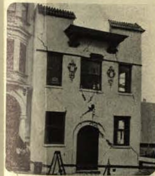
FIG. 12. — Crevasse d'une façade attaquée par une vague sismique dans son plan. La crevasse montre l'insuffisance de liaison d'une maçonnerie de brique d'apparence très résistante.
