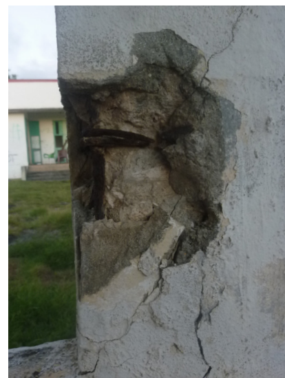
Épaisseur des enduits des piliers de l'école Sainte-Geneviève, vacante depuis 30 ans
