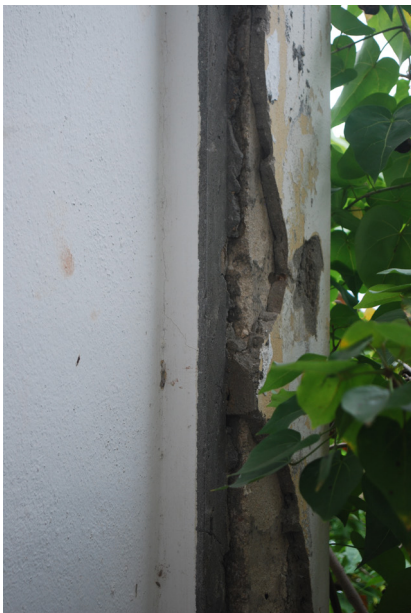
Enduits du palais de justice de paix de Port-Louis, vacant et mis à nu
