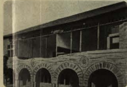
FIG. 7. — Renversement de la façade de l'étage. Intérieur resté intact, rez-de-chaussée et fondations non désorganisées. Mêmes effets qu'à Messine.
