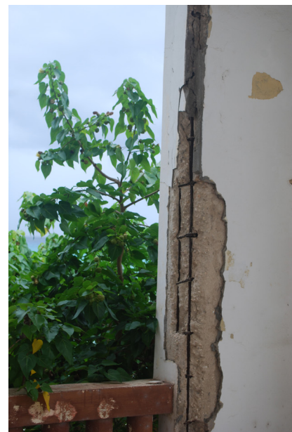
Bétons armés du palais de justice de paix de Port-Louis, vacant et mis à nu
