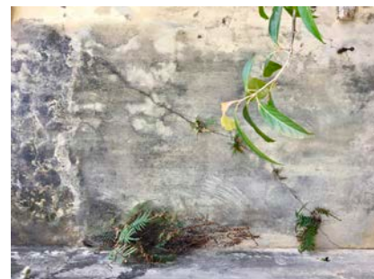
Groupe scolaire de Morne-à-l'Eau, fissure diagonale dans la maçonnerie du mur latéral du logement des enseignants. La collecte de l'eau de ruissellement par la fissure, combinée avec l'étanchéité des revêtements de surface, permet la croissance d'un jardin vertical
