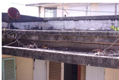
Accélération de la corrosion des armatures par l'ajout d'étanchéités non perspirantes sur les chéneaux et toitures de Morne-à-l'Eau
