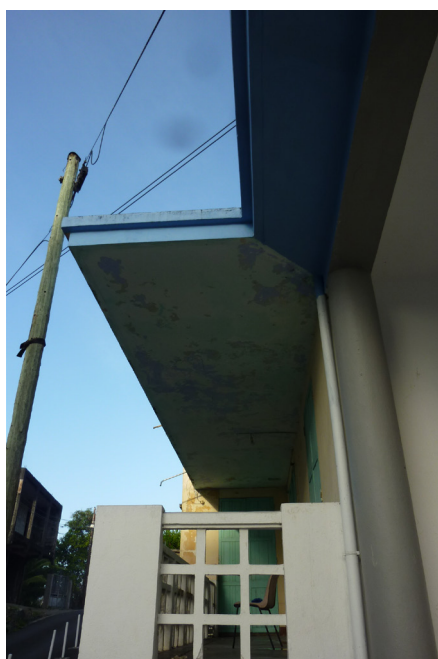
Débord de dalle du logement des enseignants du groupe scolaire de Morne-à-l'Eau
