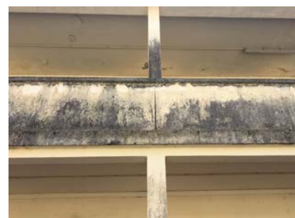
Groupe scolaire de Morne-à-l'Eau, galerie sur cour. L'autonomie entre ossature et parois est attestée par les fissures entre les deux composants de la construction. Les fissures sont issues des sollicitations du séisme du 21 mars 2021.
