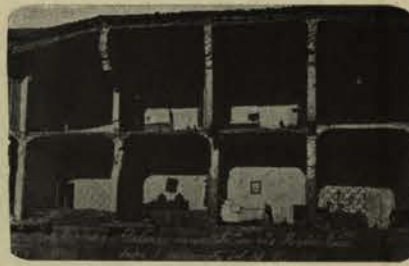
FIG. 2. — Immeuble complètement détruit, intérieurs en ruines. Les éléments horizontaux et verticaux des poutres restés debout montrent encore que les fondations n'ont pas été désorganisées.
