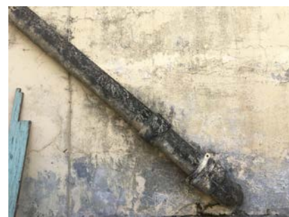
Groupe scolaire de Morne-à-l'Eau : mur de l'escalier principal vu de la cour, descente d'eau ajoutée vers le réservoir, fissures de comportement de la maçonnerie et traces de perspiration différentielles des maçonneries et béton armé. La perspiration constitue des spectres qui permettent de découvrir et lire la construction. Ces possibilités qui sont augmentées en situation tropicale indiquent l'importance constructive et sanitaire de la perspiration.
