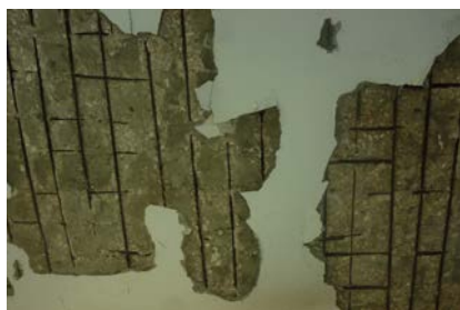
Corrosion des armatures de la galerie de l'école Sainte-Geneviève, vacante depuis 30 ans : étanchéités de surface fissurées et peinture non-perspirante des années 80
