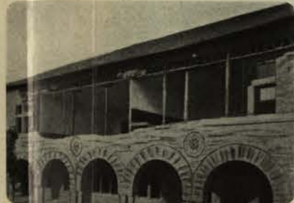
FIG. 7. — Renversement de la façade de l'étage. Intérieur resté intact, rez-de-chaussée et fondations non désorganisées. Mêmes effets qu'à Messine.
