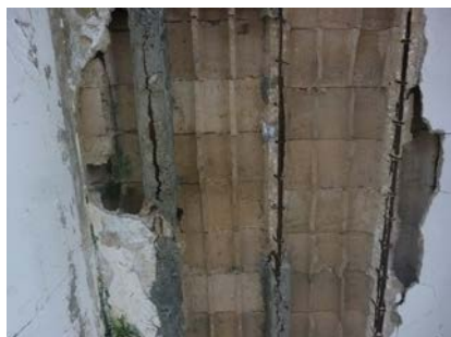
Écorché de l'enduit de protection et des hourdis des plafonds de l'école Sainte-Geneviève, vacante depuis 30 ans
