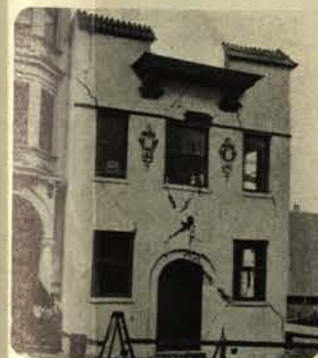
FIG. 12. — Crevasse d'une façade attaquée par une vague sismique dans son plan. La crevasse montre l'insuffisance de liaison d'une maçonnerie de brique d'apparence très résistante.
