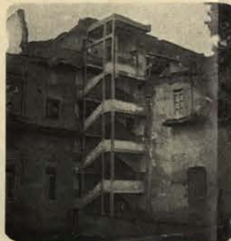
FIG. 18. — Escalier en béton armé. Le bâtiment qu'il desservait s'est effondré.
