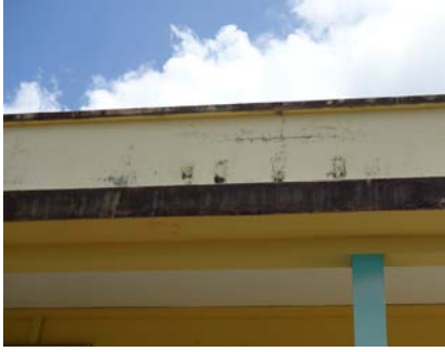
Traces des barbacanes obstruées de l'école des filles des Grands-Fonds du Moule
