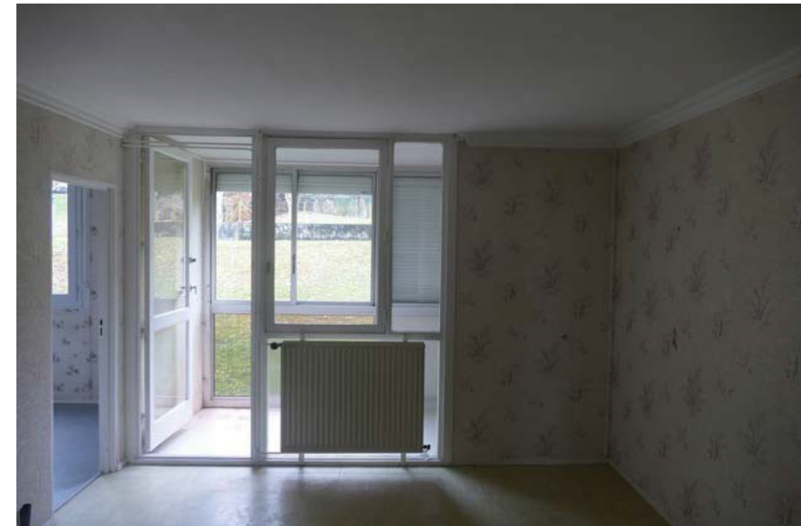
Figure 4 : Façade intérieure séjour avec Loggia | Barre « Peupliers ». Au premier plan, le panneau d'origine, type Z (1958) Au second plan, le panneau de la réhabilitation (1989).
