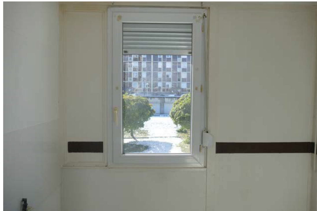
Figure 10 : Façade intérieure cuisine | Barre « Peupliers ». Cadre bois d'origine (Panneau type U) et intégration menuiserie PVC après réhabilitation.
