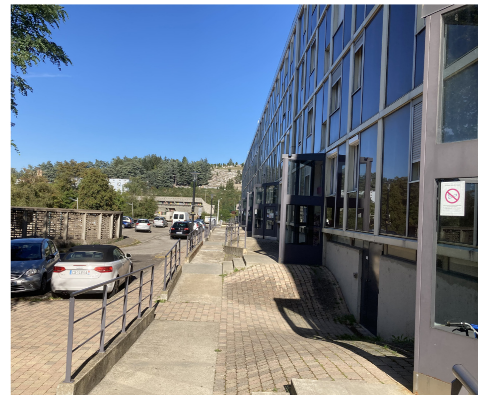
Figure 4 : Altérations des pieds d'immeubles consécutives à la création de rampes pour accessibilité PMR, au changement de revêtement de sol, aux modifications entrées, au stationnement sauvage, etc.
