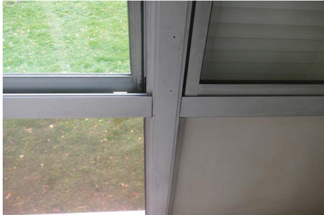
Figure 5 : Détail menuiserie extérieure loggia | Panneau d'origine (1989).
