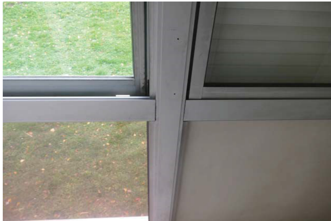
Figure 5 : Détail menuiserie extérieure loggia | Panneau d'origine (1989).
