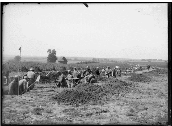
SPA 11 Z 238 Morfontaine. Progression du travail. Vue prise à l'emplacement du n°234
