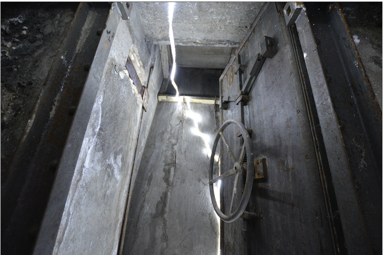
Fig. 42 : vue d'une des deux portes étanches ouvrant sur la cour. © N. Samuelian, Inrap
