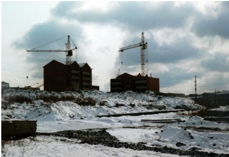
Photo 23 Le long et rigoureux hiver, un frein aux chantiers de construction Cliché L. Touchart, octobre 1996
