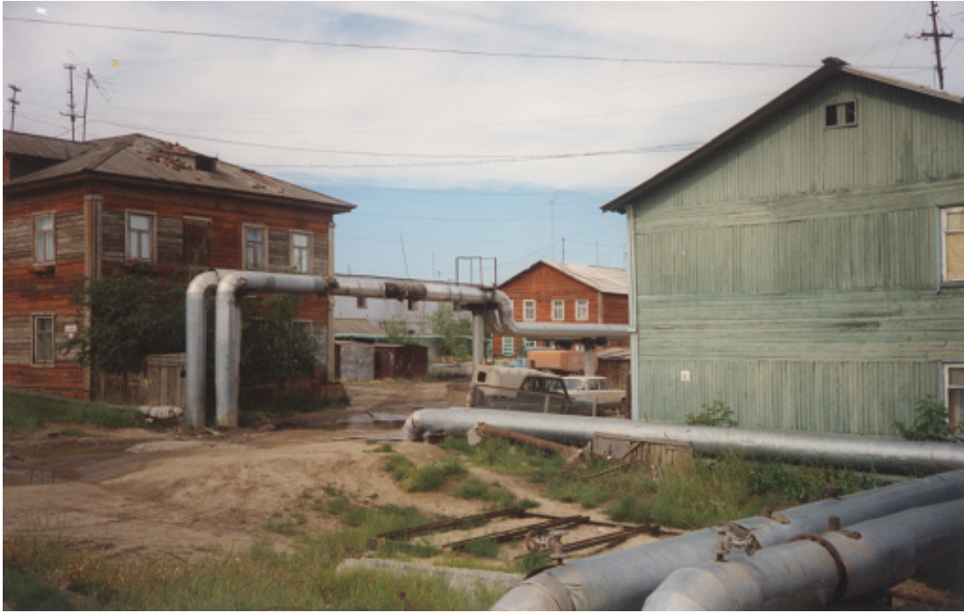
Photo 19 Canalisations et fluides dans le Grand Nord Cliché L. Touchart, juillet 1991
