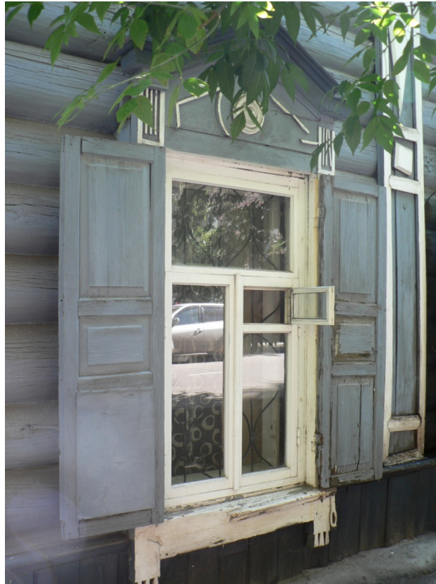
Photo 14 Colmatage contre l'entrée d'air froid ou risque d'asphyxie ?
