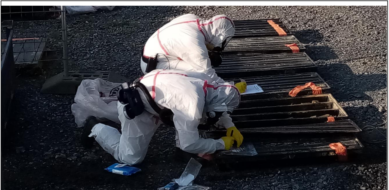
Figure 5: opération de prélèvement d'échantillons sur carottes lors d'une mission de repérage d'amiante environnemental. Source Cerema
