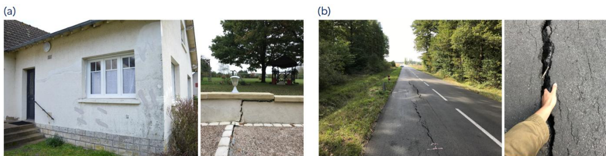
Figure 2. Exemples de dommages imputables à la sécheresse et au phénomène de RGA : (a) fissuration de la structure d'une maison, (b) fissuration d'une route départementale.
