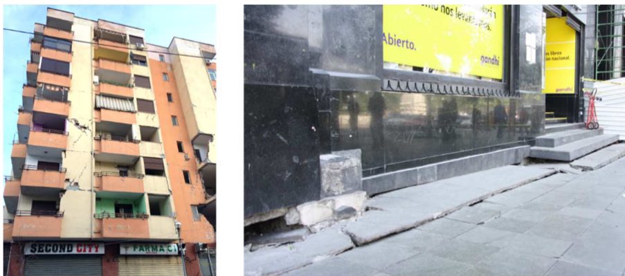
Figure 1. À gauche : relevé des désordres sur un bâtiment à 8 niveaux (séisme de Durrës du 26/11/2019). À droite : désordres à l'interface sol-ouvrage (séisme de Mexico du 19/09/2017). Source des photographies : AFPS.
