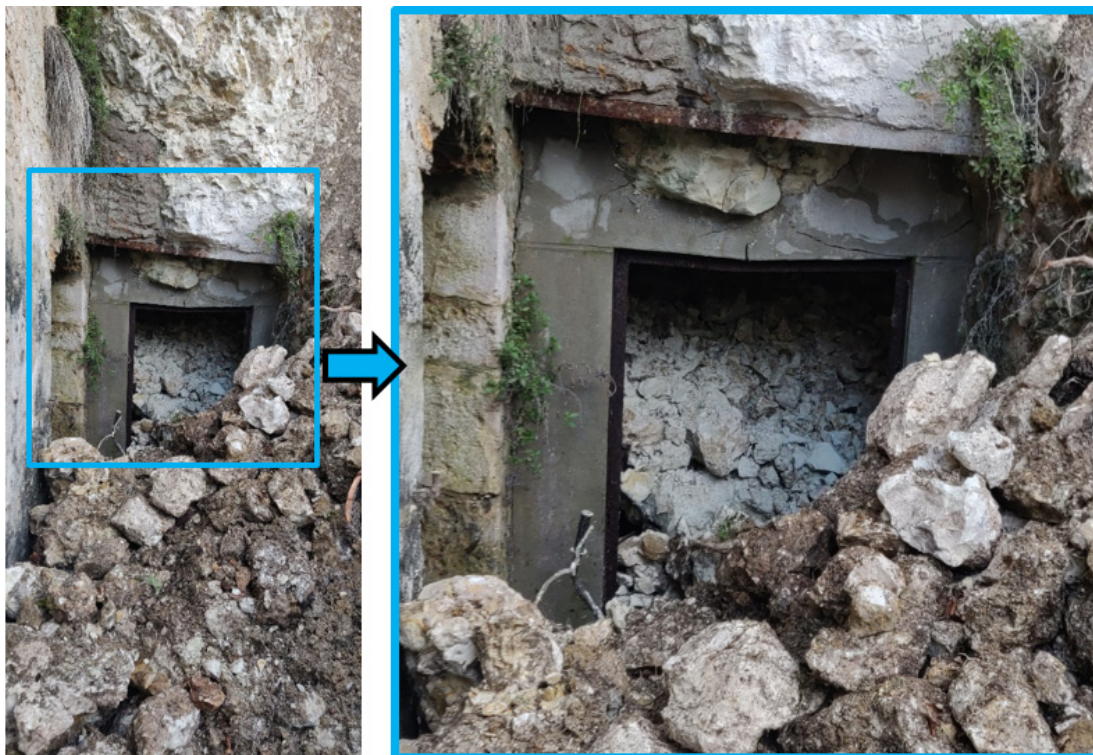
Figure 5. Cave effondrée à l'aplomb de l'éboulement de 2019 (photographie prise par un sinistré)
