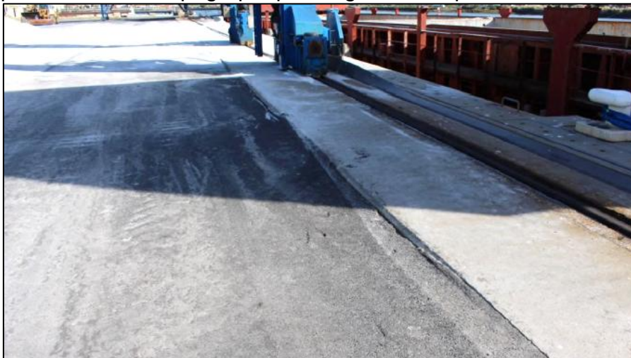
Figure 3. Tassement différentiel visible
